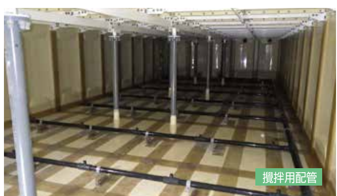
凍結防止溶液貯留タンク
