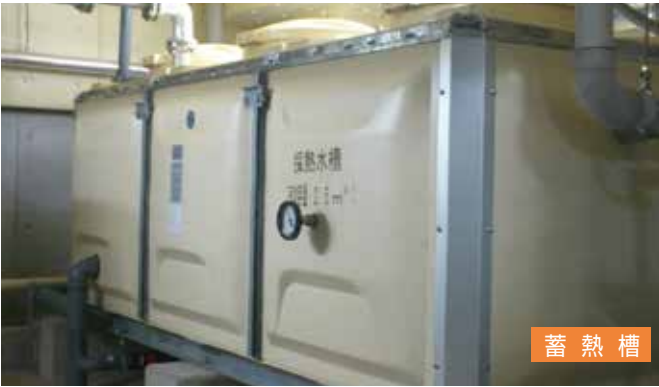
貯湯槽・温泉槽
