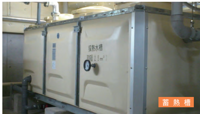
貯湯槽・温泉槽
