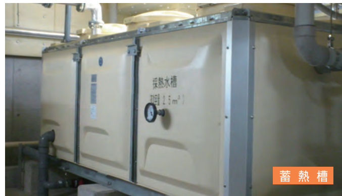
貯湯槽・温泉槽
