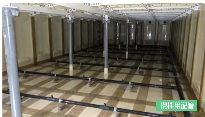
凍結防止溶液貯留タンク
