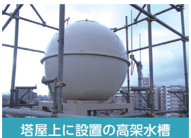
塔屋上に設置の高架水槽
