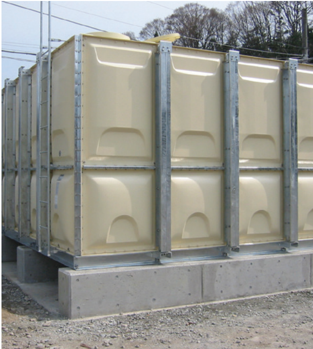
Fパネルタンク
