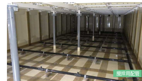
凍結防止溶液貯留タンク
