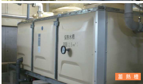
貯湯槽・温泉槽
