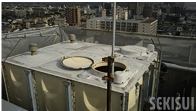
1-既設の高置水槽
