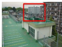
高架水槽イメージ（屋上に設置）
