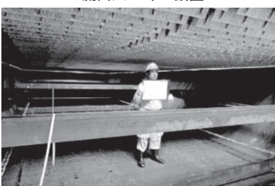
写真-2 装置の外観(底部) 汚泥かき寄せ機上部に設置
